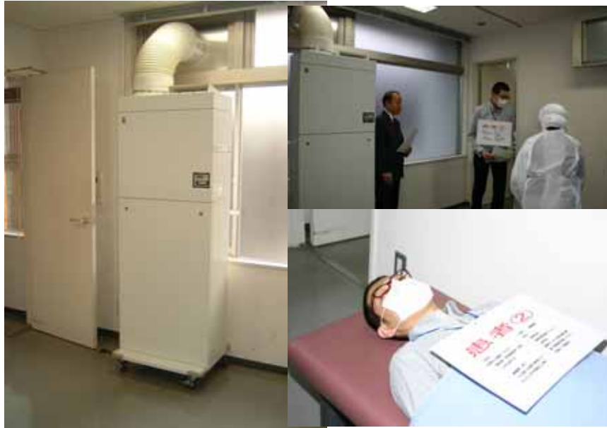
十分な換気 ① を確保する 必要に応じて陰圧式空気清浄機 ② 等を使用する
